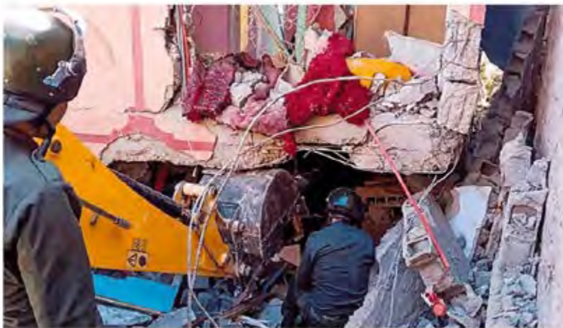
Fieberhafte Suche nach Vermissten unter den Trümmern
