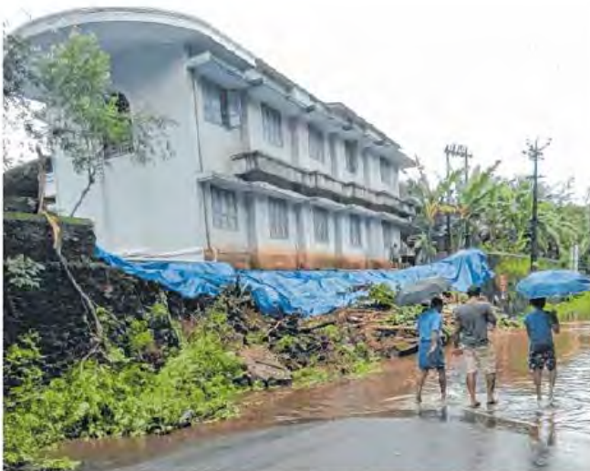
Die Flut hat das Mauerwerk des Anna-Dengel-Spitals in Bharananganam stark beschädigt. Eine rasche Reparatur ist notwendig. Foto: Freunde Anna Dengel
